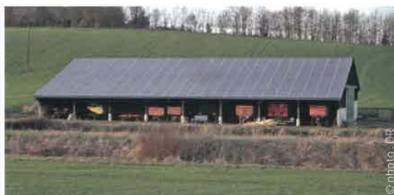
Sur ce hangar, les panneaux photovoltaïques couvrent la totalité d'un pan de toiture.
